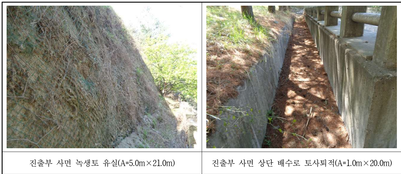
【사진 3.10】 사면 손상현황
